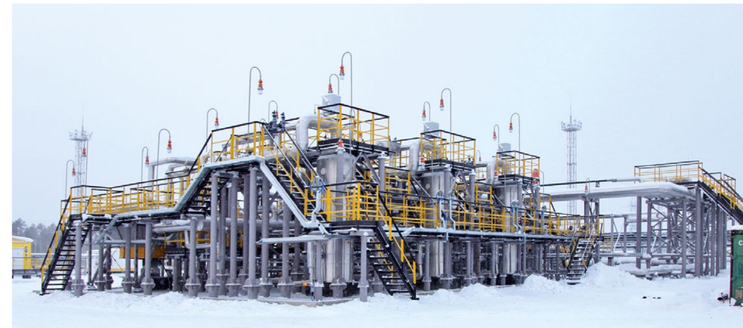
В «РН-Юганскнефтегазе» введен в эксплуатацию новый газовый цех – ЦСПГГ №6. Он ответственен за подготовку товарного газа с Угутско-Киньяминской группы месторождений
